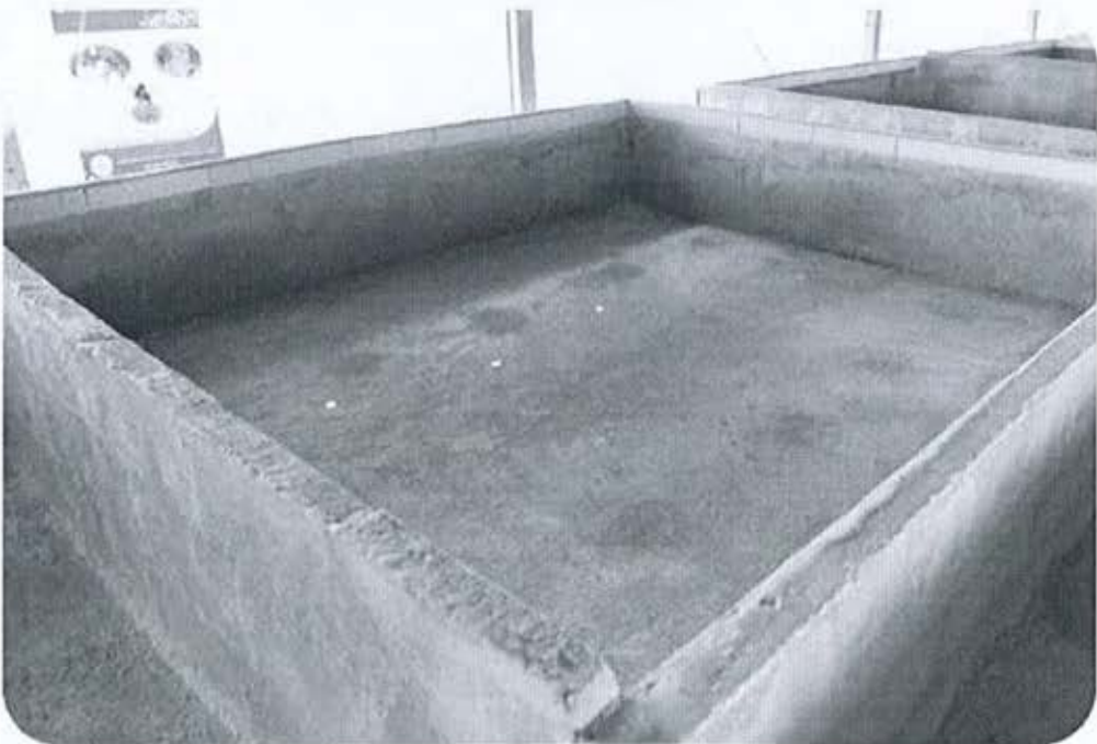
บ่อซีเมนต์ ทนทาน แข็งแรง ควรฉาบเรียบ เพื่อให้ง่ายต่อการทำความสะอาด
